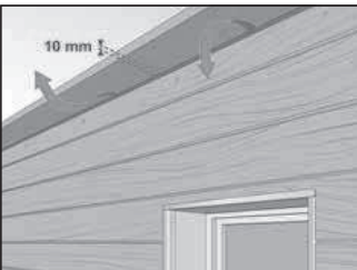
Отрежьте верх последней доски в продольном направлении до необходимой высоты, сохраняя минимальный зазор 10 мм между фасадом и кровельным свесом.
